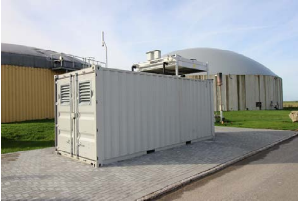
Elektrolyse/Verdichtung am Windpark
